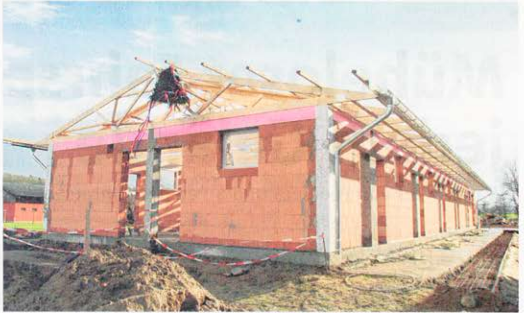
Richtfest für den neuen Abferkelstall, der auf 300 Quadratmetern und im Außengehege Platz für 20 Muttersauen bietet.
